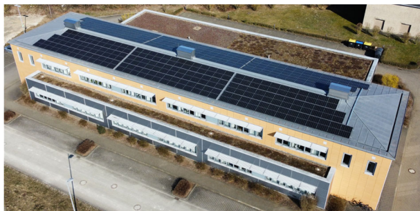
Foto: PV-Anlage 1– WF - Exer 19 h/i - 99kWp
